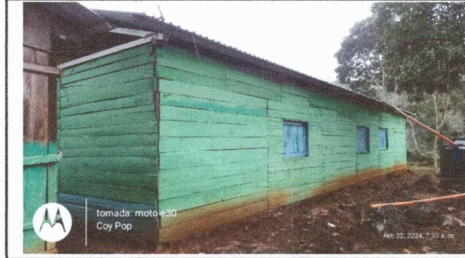
Foto 1: Se observa el estado de las paredes deterioradas por la humedad del suelo.
